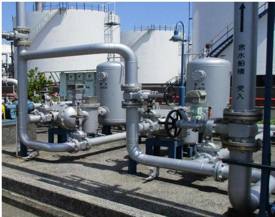
③-1 船積み出荷配管 2系列
